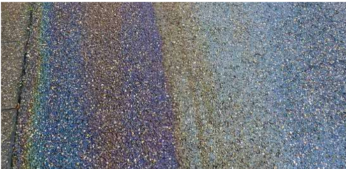
Les carburants, les huiles moteur et les métaux lourds rendent le ruissellement des eaux de pluie dangereux.
